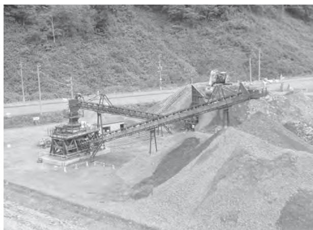
破碎設備 (コーンクラッシャー)
