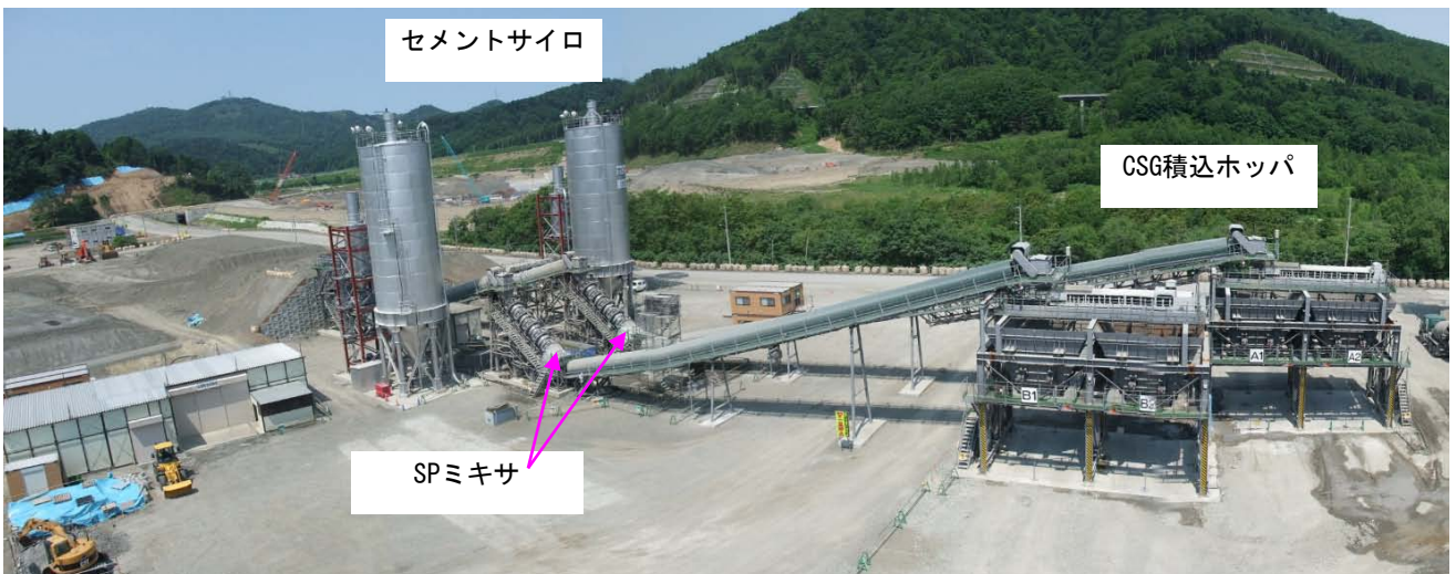
CSG製造設備 全景 (平成21年6月28日撮影)
