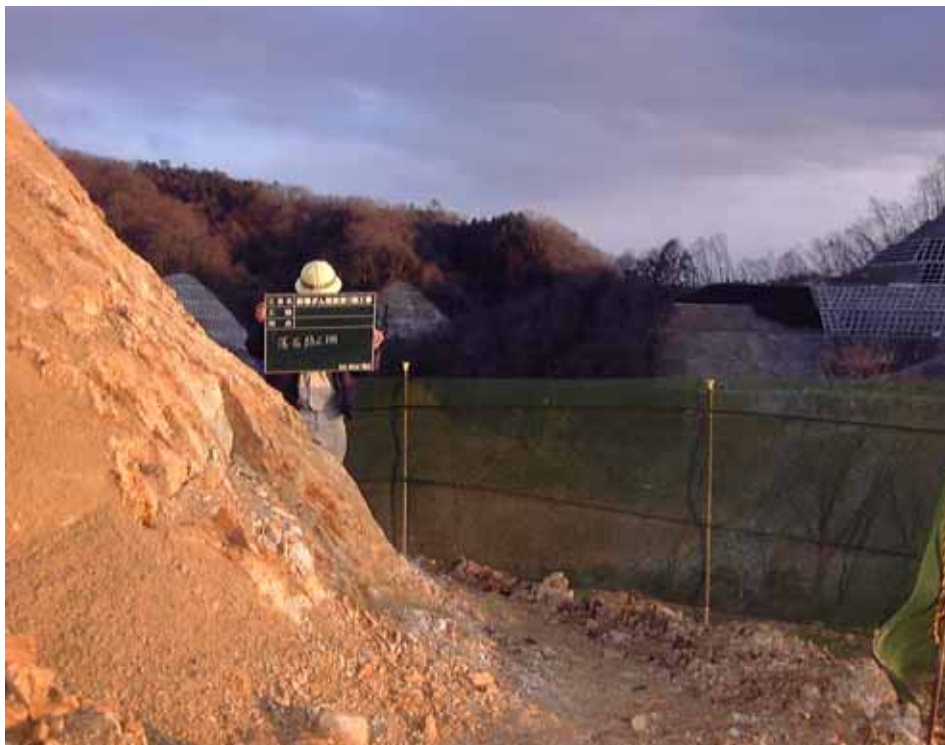
落石防護ネット柵
